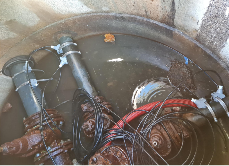
Tre par ultraljudssensorer för flöde installerade på vattenrör
