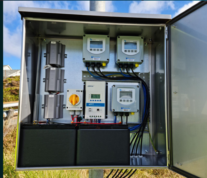
LEAKCELL LC221 med två ultraljudsflödesmätare, mobil-sändare, batteri och laddningsregulator till solpanel.
