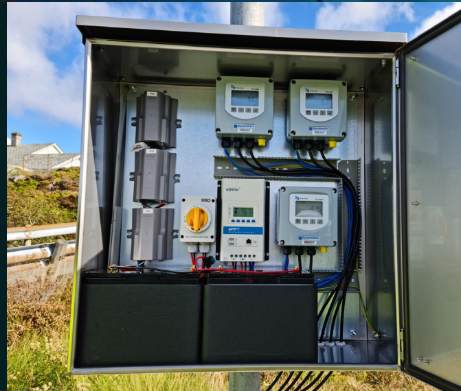
LEAKCELL modell LC322 med tre ultralydflowmålere, batteri og laderegulator koblet til solcellepanel.
