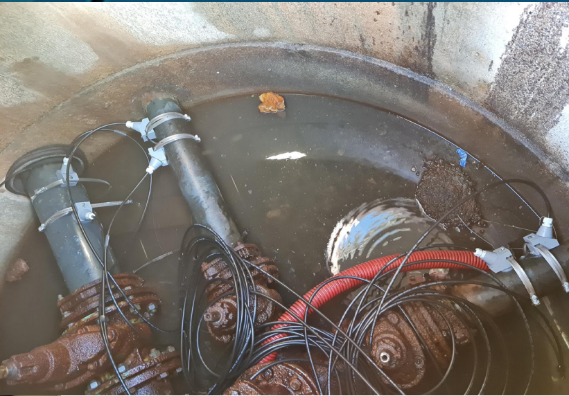
Tre par ultrasoniske Clamp-on flowsensorer installert på vannrør
