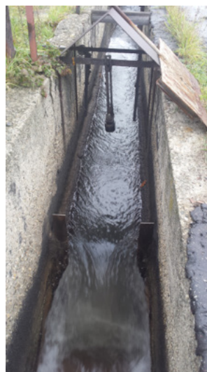
Nivå och flödesmätning med iSonic 4000 i öppen kanal
