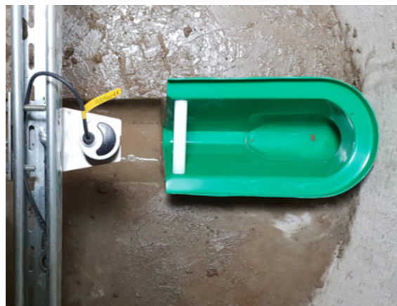
Nivå och flödesmätning med iSonic 4000 i brunn
